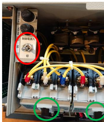
図9 制御盤内電源部
