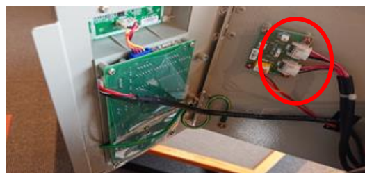
図10 制御盤内配線部
