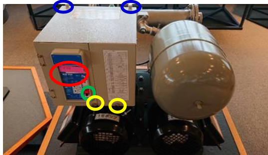
図8 給水ポンプ外観部
